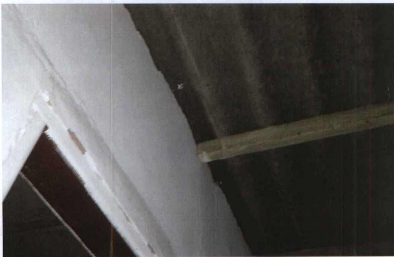
(FOTO 10 – MOSTRA PARTE DO IMÓVEL SEM FORRO, APENAS COM A COBERTURA EM TELHA DE FIBRO AMIANTO)
