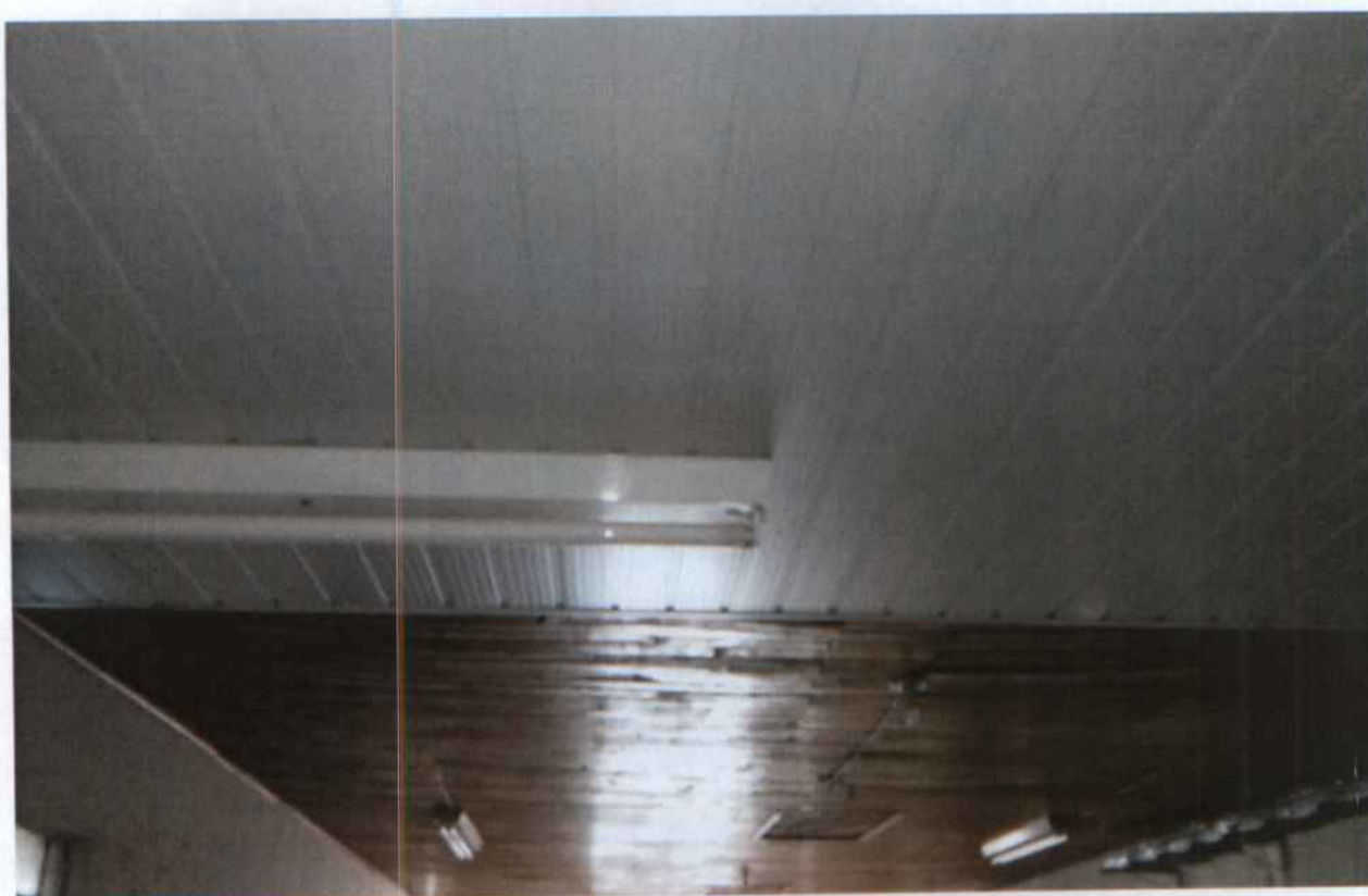
(FOTO 14 – MOSTRA PARTE DO FORRO, EM MADEIRA E PARTE EM PVC – SALÃO COMERCIAL)
