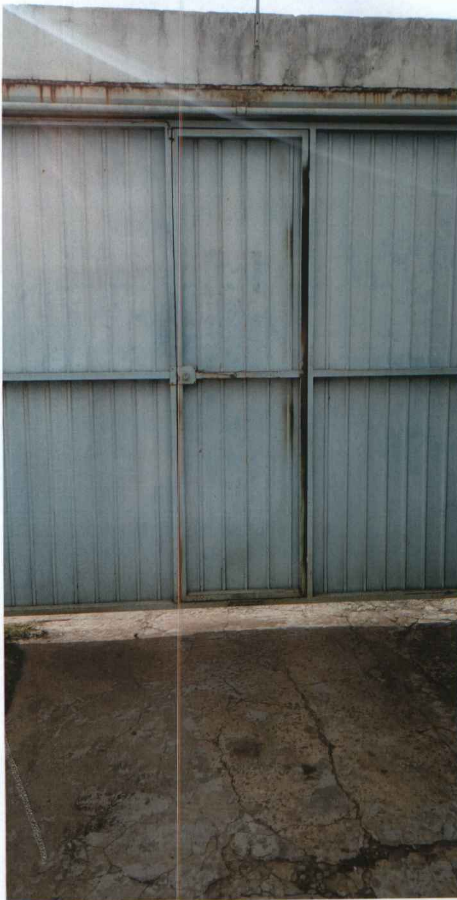
(FOTO 04 – MOSTRA PORTÃO DE ACESSO AO IMÓVEL, EM RUIM ESTADO DE CONSERVAÇÃO – CASA – LADO DE DENTRO)
