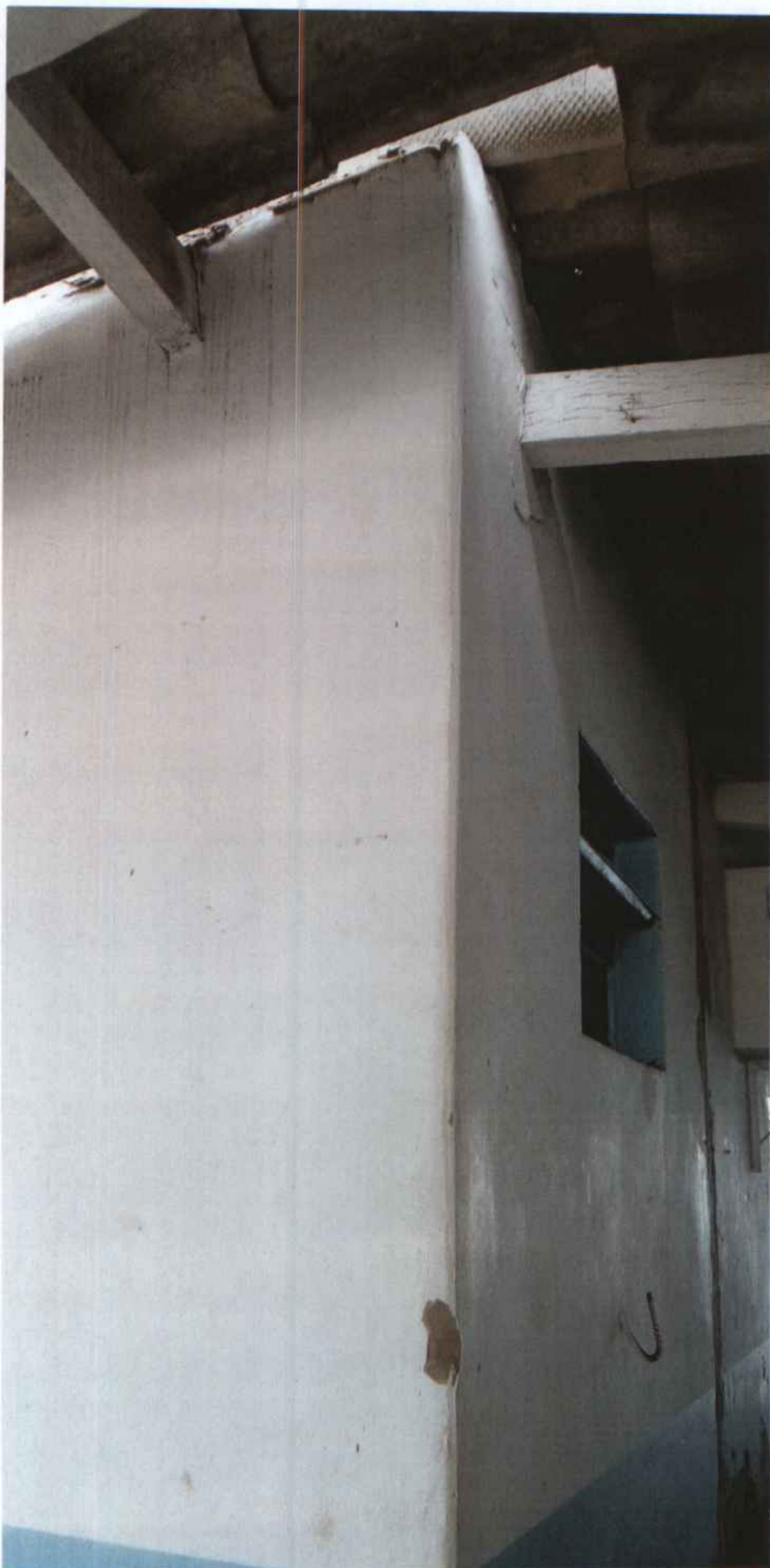
(FOTO 05 – MOSTRA ESTRUTURA DA PAREDE E COBERTURA EM TELHA DE FIBRO AMIANTO – CASA – RUIM ESTADO DE CONSERVAÇÃO)
