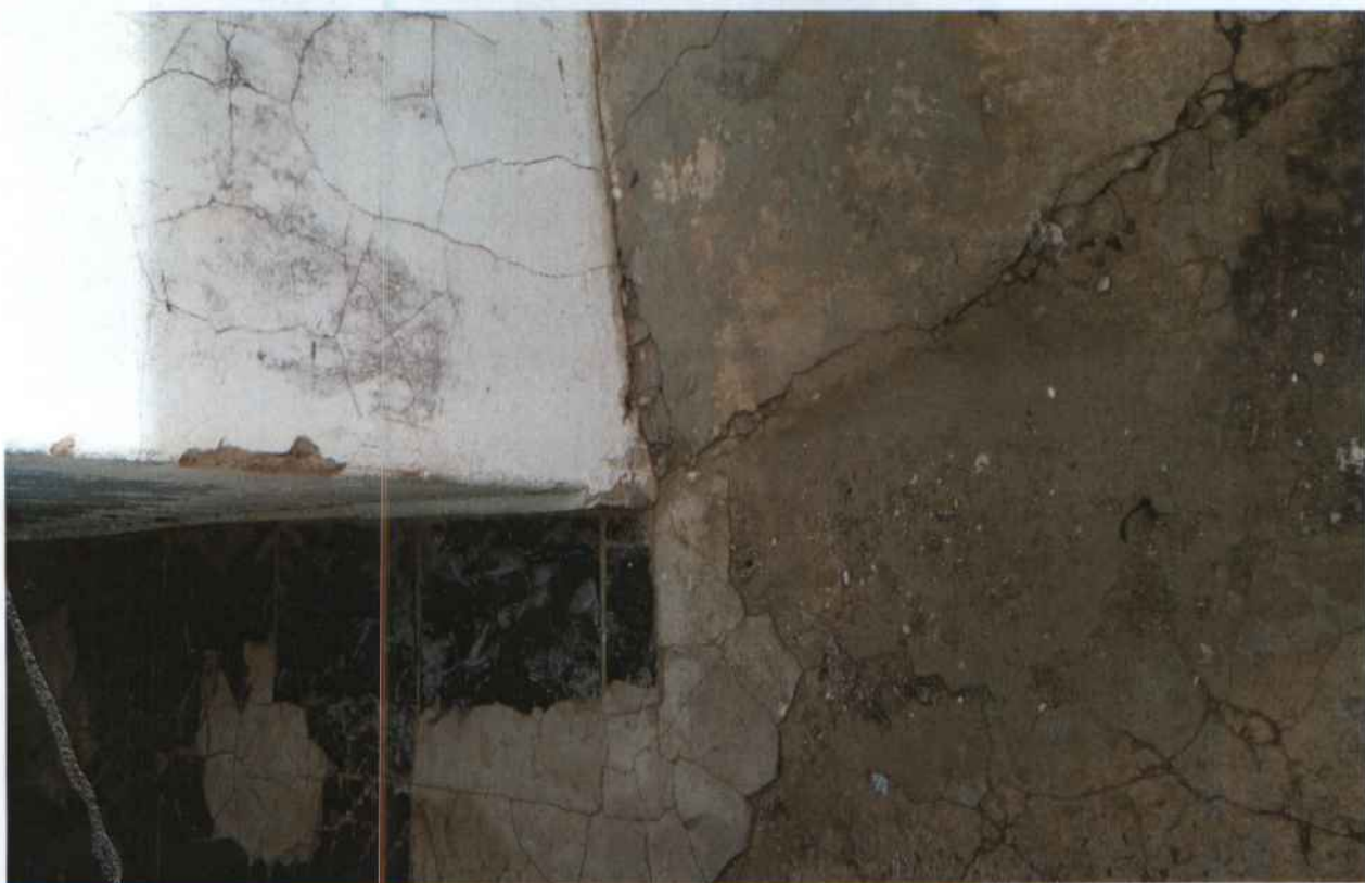
(FOTO 08 – PARTE EXTERNA – MOSTRA ESTADO DE CONSERVAÇÃO DO IMÓVEL )
