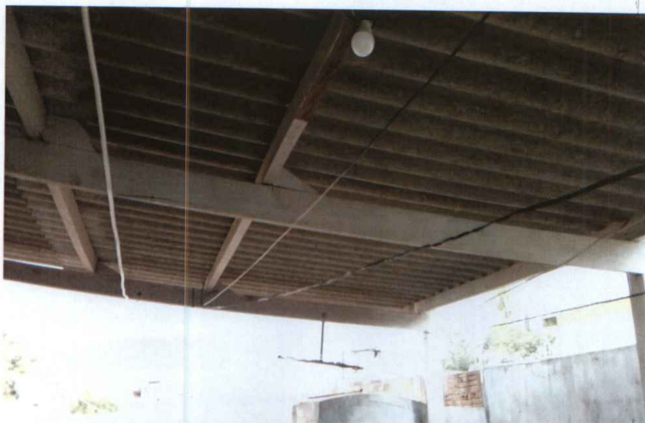
(FOTO 11 – MOSTRA COBERTURA DA VARANDA, EM TELHA DE FIBRO AMIANTO - CASA)
